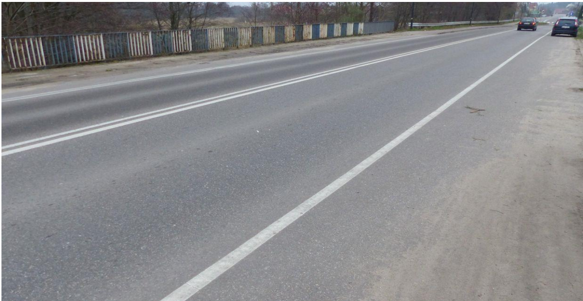
Fot. 14 Nawierzchnia jezdni
