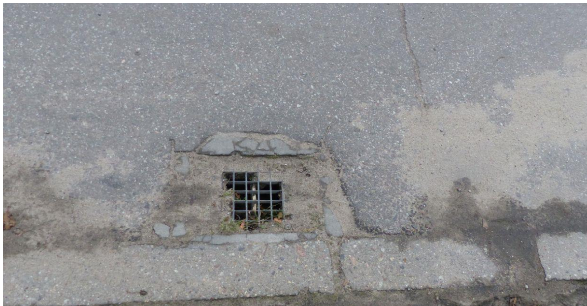
Fot. 21 Urządzenia odwadniające
