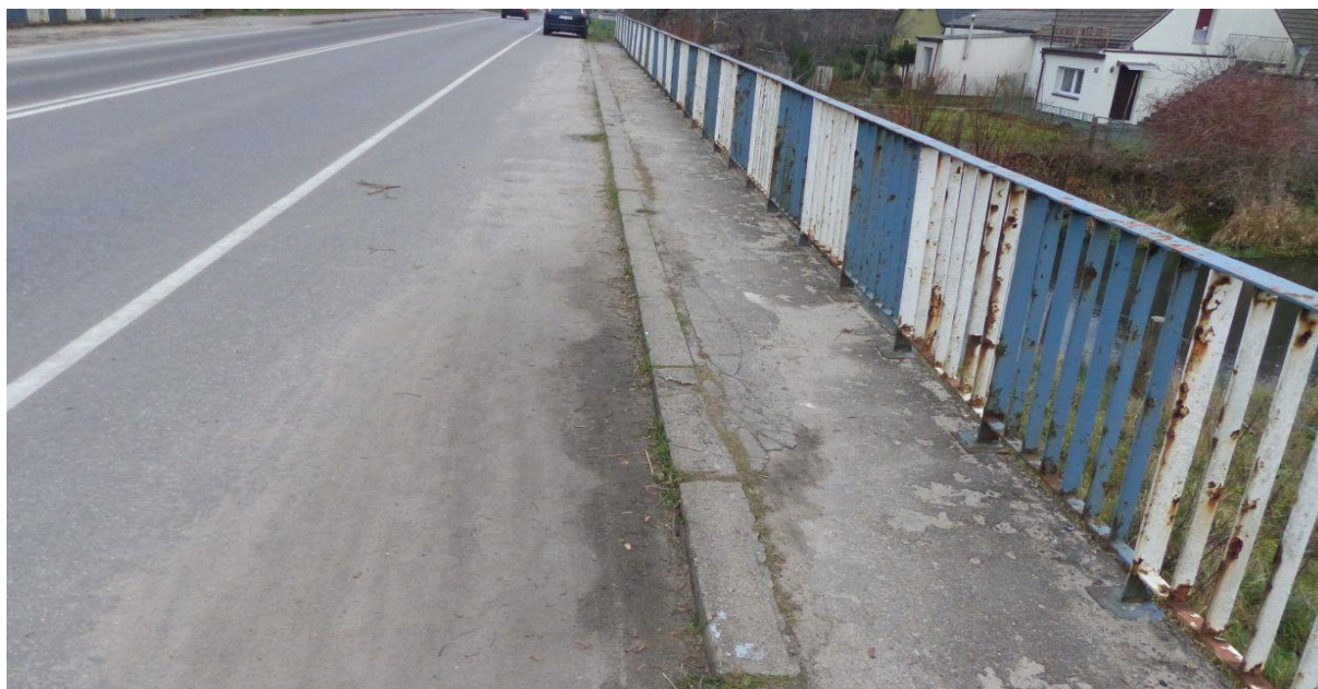
Fot. 16 Nawierzchnia chodników, krawężniki
