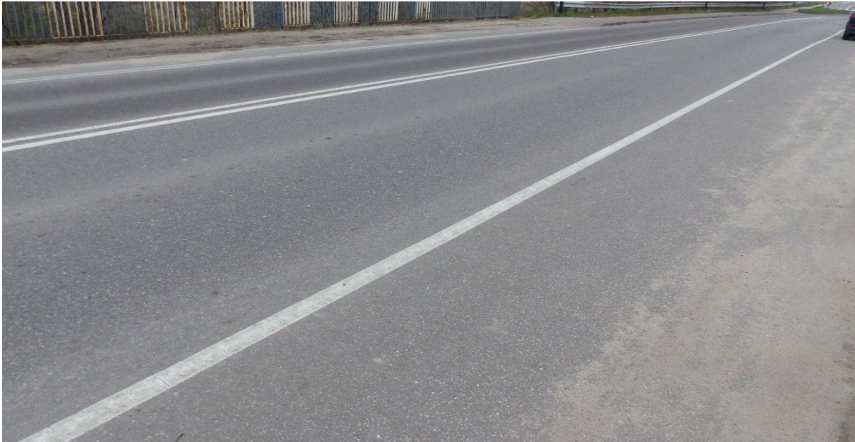
Fot. 13 Nawierzchnia jezdni
