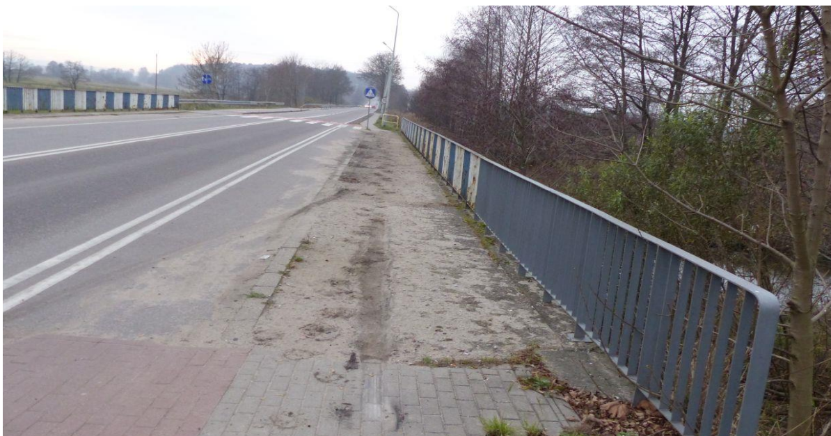
Fot. 15 Nawierzchnia chodników, krawężniki
